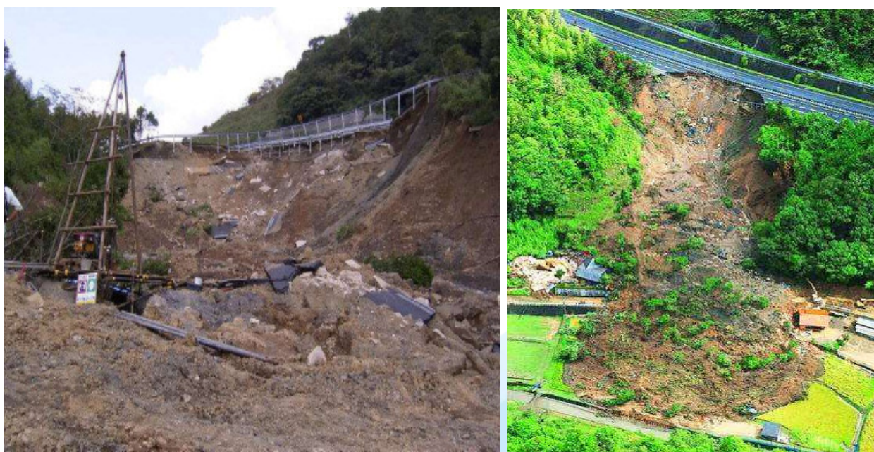
山陽自動車道岩国市（甘木地区）高盛土崩壊現場（法先からと上空からの写真 2005.7）
